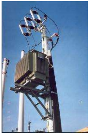
Typowy trafo SN/NN 630kVA
