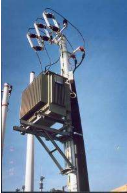
Typowy trafo SN/NN 630kVA ok. 100-150 mieszkań
